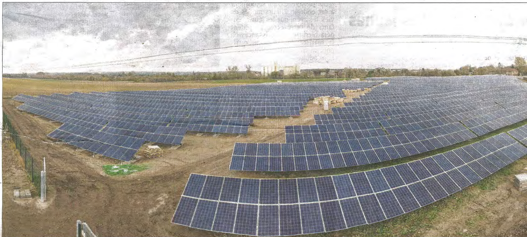
La puissance maximale de cette centrale photovoltaïque est de 5,5 mégawatt.
